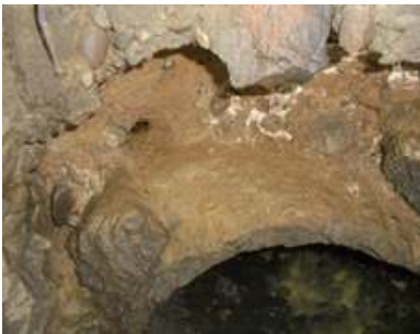
벽체 파손 및 토사 유실
