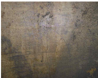
경미한 균열 (b)
