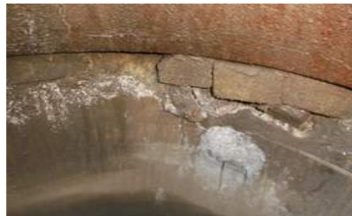
높이 조정재 콘크리트블록 손상상태
