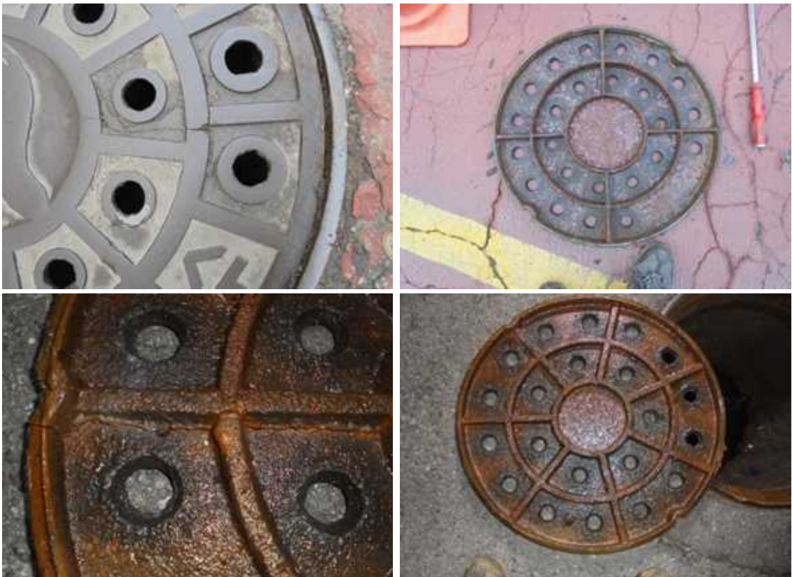
[그림 3.26] 맨홀(작업구)뚜껑 균열 발생 상태
