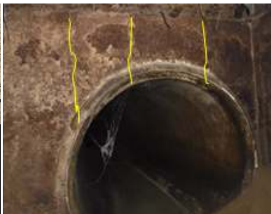
균열 0.5mm, 면적율 20%미만 (d)
