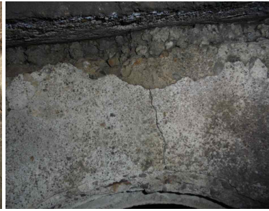
파손깊이 50mm이상, 10%미만 (c)
