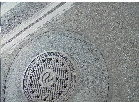
2015년 정비한 현재의 균열상태 (F공법)
