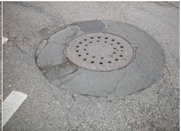
2013년 정비한 현재의 파손상태 (A공법)
