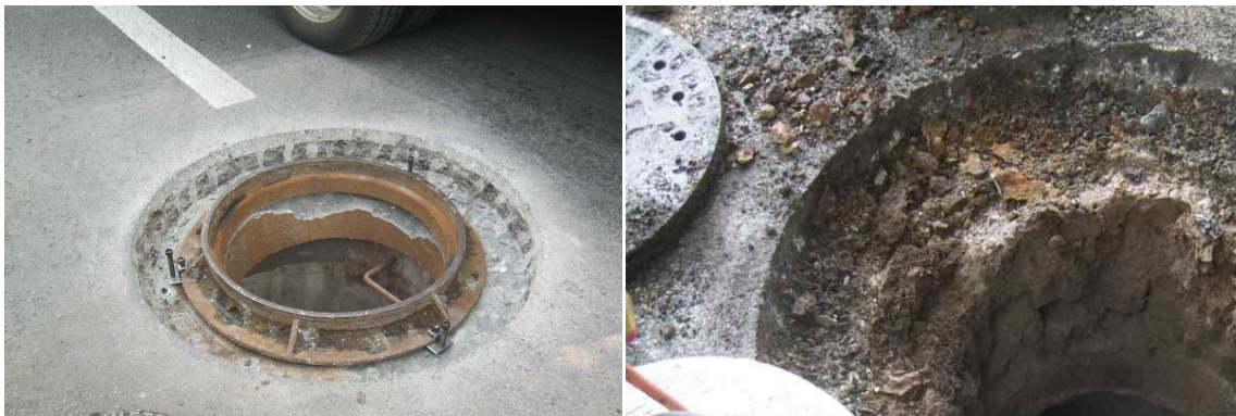
맨홀(작업구) 상부 파손상태 (치핑주의)
