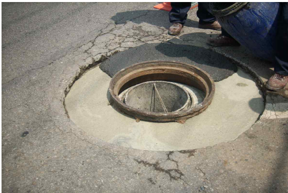
맨홀(작업구) 외측의 손상의 정비제외 전경
