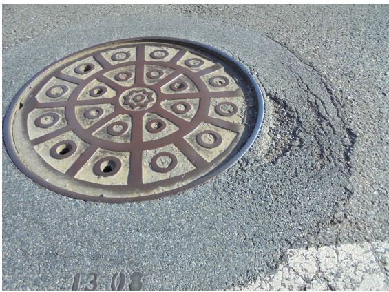
2013년 정비한 현재의 파손 및 덜컹거림 (A공법)
