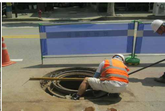
높이조정 전경(유압고정 장치 미설치)
