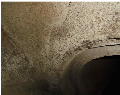
균열 0.3mm, 면적율 20%미만 (c)
