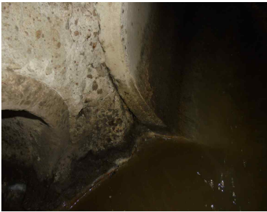
파손깊이 50mm이상, 10%미만 (c)
