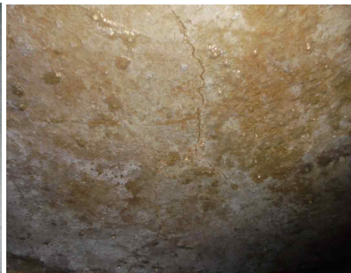
균열 0.3mm, 면적율 20%미만 (c)
