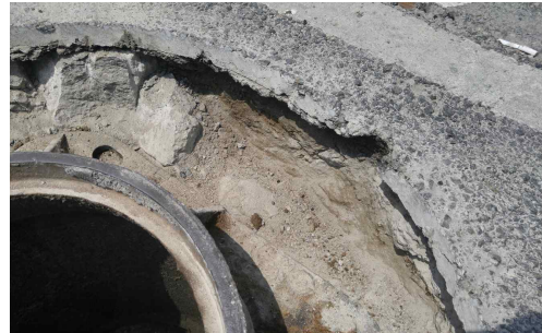
브레이커 작업에 의한 포장손상 전경
