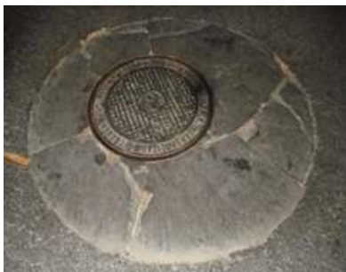
맨홀(작업구)주변 포장부 파손
