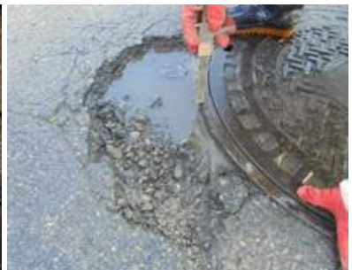
맨홀(작업구)주변 포장부 파손
