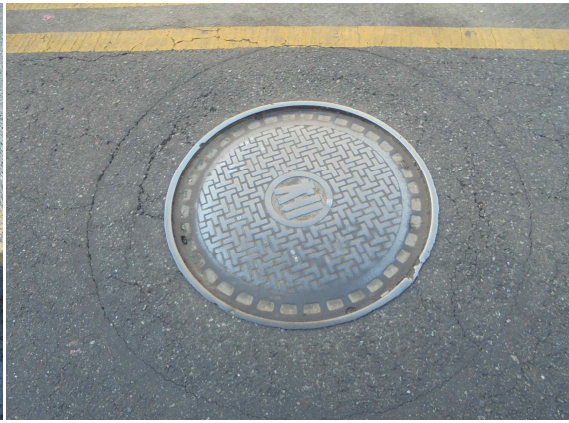
2013년 정비한 현재의 균열 및 덜컹거림 (B공법)
