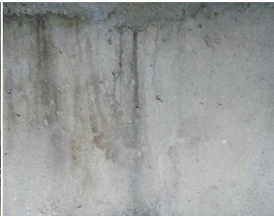
경미한 균열 (b)
