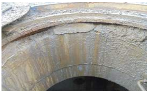
높이 조정재 파손상태
