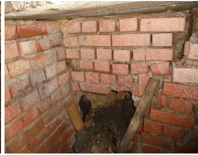
벽체 파손 및 이격, 배면공동 상태
